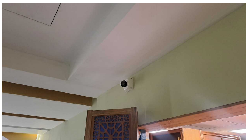
▲ سیستم اعلام حریق داخل مخزن، رطوبت سنج محیط و دوربین‌های امنیتی
