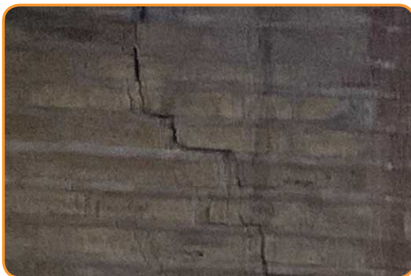
ترک های موجود در بالای تاق ها
