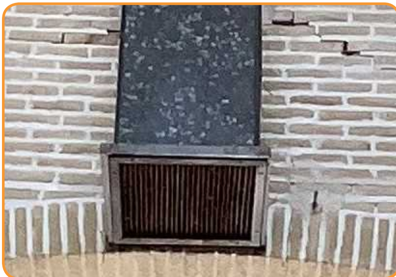
ترک های موجود در دیواره ها
